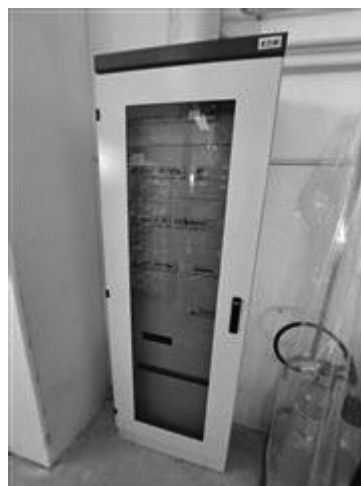
quadro impianto elettrico
